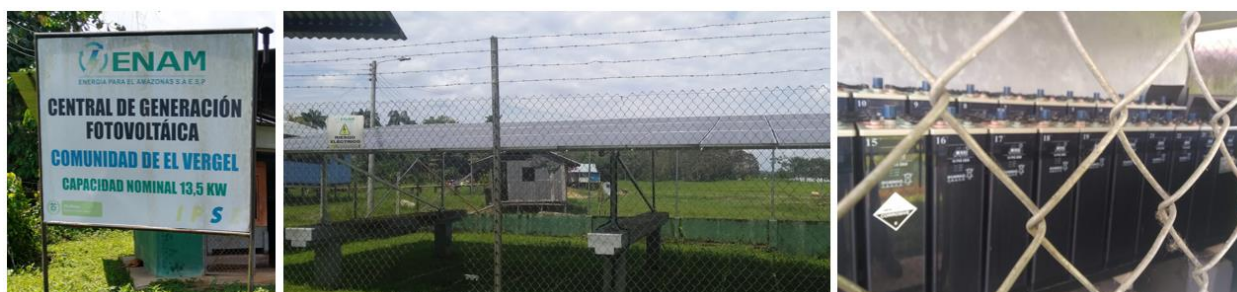
Figura IV.- Central de generación fotovoltaica y sus componentes. Fuente: Fotografías de los autores.
