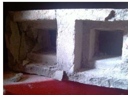
b) Mecanismo de falla – bloque sometida a compresión lateral
