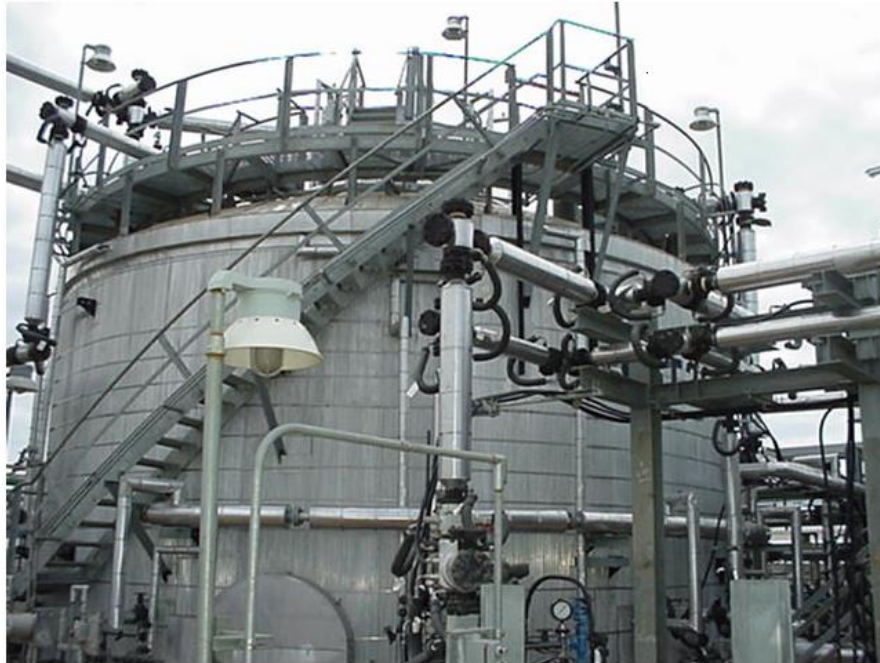
Figura I. Tanque de almacenamiento de azufre.
